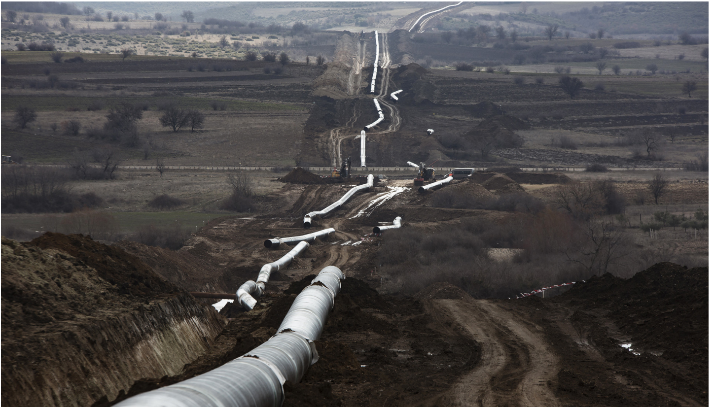
De aanleg van de Trans Adriatic Pipeline in Chamilo, Griekenland, begin 2017. Foto: Konstantinos Tsakalidis / Bloomberg
